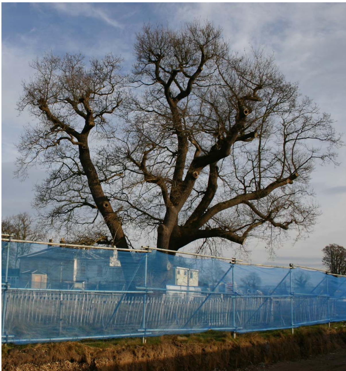
Fig. 2.10: Skyddsvärt träd på en byggsplats. Att döma av dess tidigare kronstorlek (innan den beskärning som uppenbarligen ägt rum), nådde dess rotsystem, med god marginal, in i det område som har påverkats av grävning och jordförtätning.
